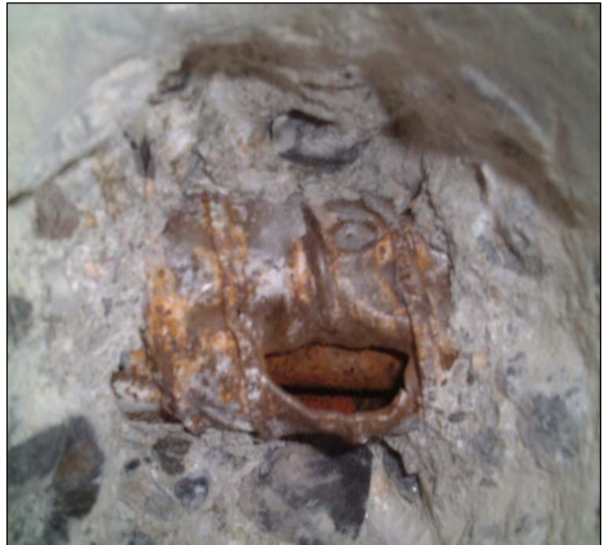
グラウト未充填部
